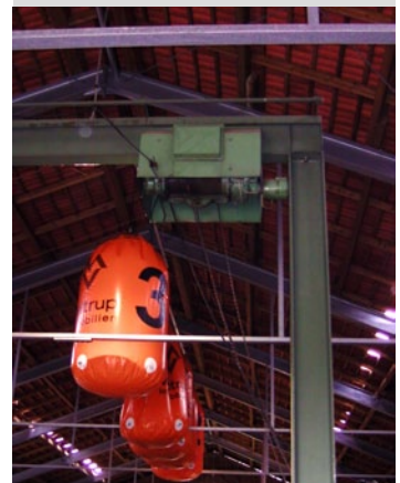
Bild: Hallenkran wieder einsatzbereit
